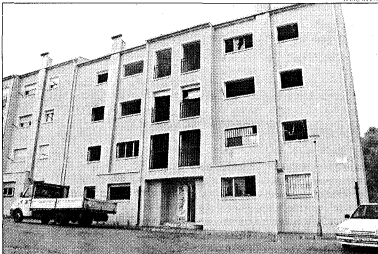
Pisos afectats. Aquests habitatges aniran a terra en breus dies.
