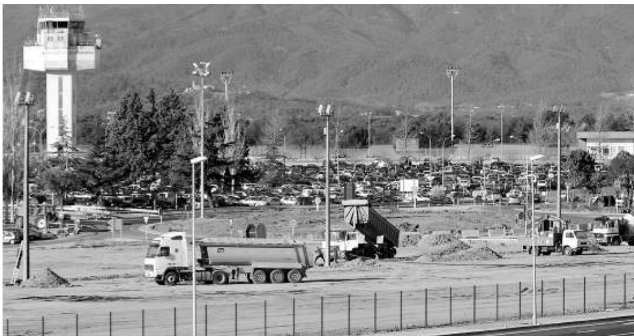
L'aparcament en obres, aquest dimecres. Avui ja estarà en ple funcionament per evitar que els cotxes aparquin a la carretera. / M. LLADÓ.
