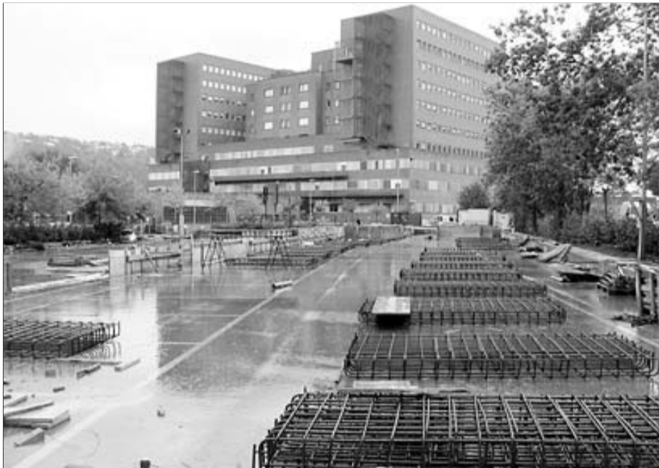
Les obres a l'aparcament on se situaran les consultes externes, a tocar del Trueta ■ D.V.
