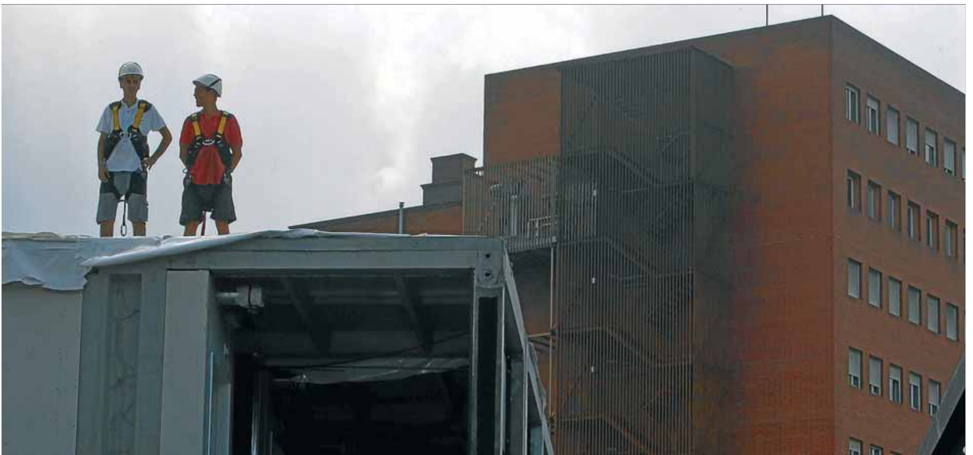
La instal·lació d'un dels mòduls de formigó, ahir durant la visita al nou edifici per a les consultes externes del Trueta i de l'ICO ■ JORDI RIBOT/ CLICK ART FOTO
