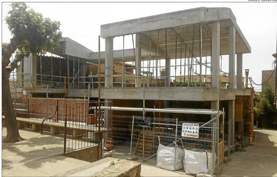
L'edifici, ubicat al carrer Fort, fa un mes que té les obres aturades.
