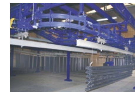
Línea de pintado de Doble Vía (P&F)
