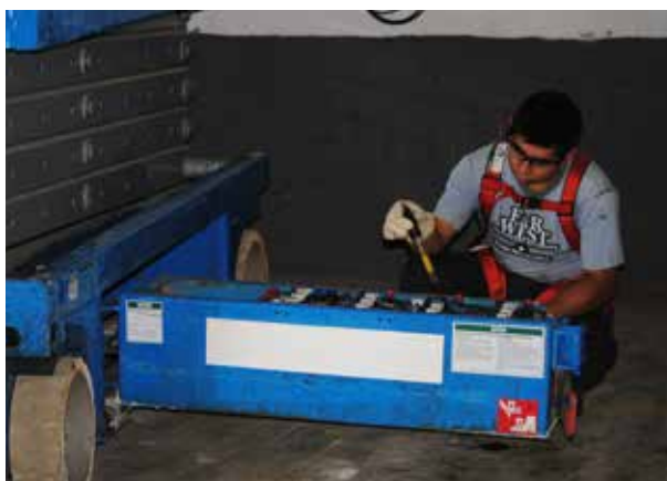
Figura 24. Falta de EPI en la comprobación o manipulación de las baterías
