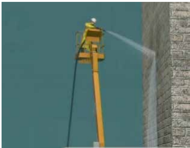
Figura 17. Utilización de manguera a presión con riesgo de superar la fuerza lateral máxima admisible
