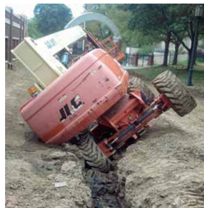
Figura 15. Vuelco por no respetar la distancia de seguridad respecto a una zanja
