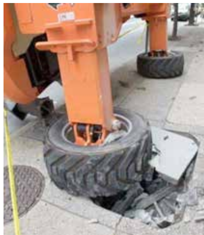
Figura 13. Apoyo de PEMP sobre una superficie poco resistente
